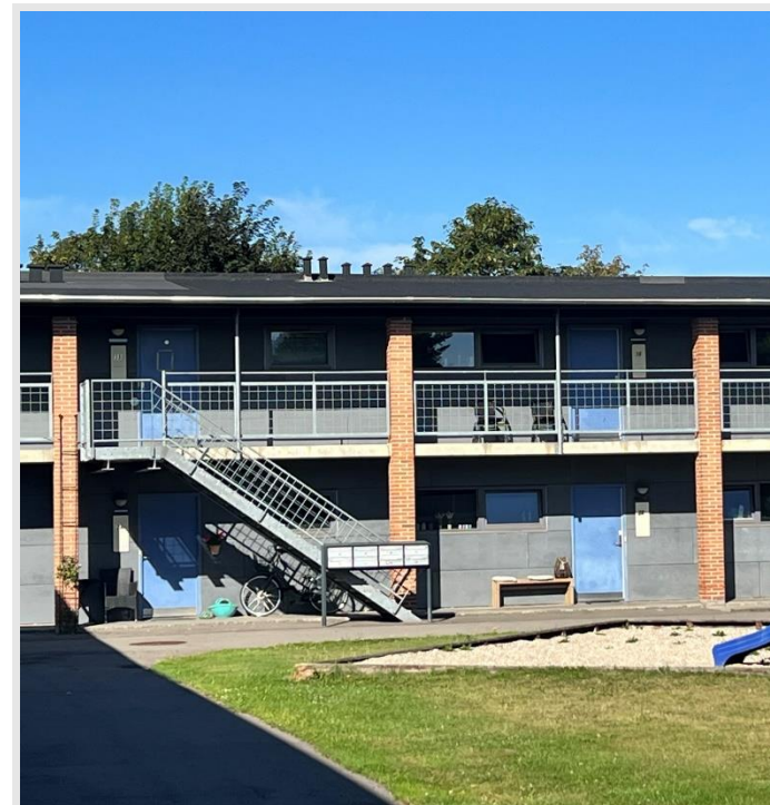
Ejendommen er i 2 etager med lav taghældning. Skader er primært konstateret ved installationsgennemføringer.
