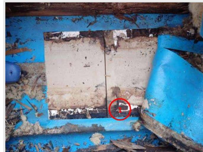
Billede fra svamperapporten fra 2022 viser synlig skimmelsvamp og fugt på overside af gipsloft.
