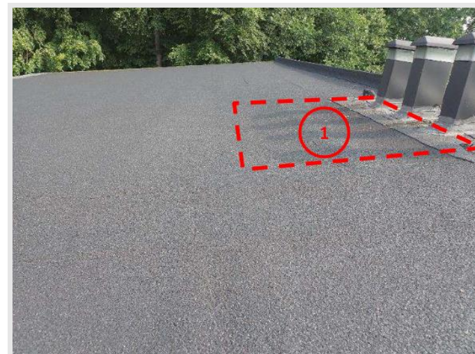
Eksisterende tagflade med ventilationshætter, hvor skadesområdet (markeret) optræder. Tagpap ser som sådan fornuftig ud med OK restlevetid. Skaden kommer indefra – ikke udefra. Foto fra Svamperapport fra 2022.
